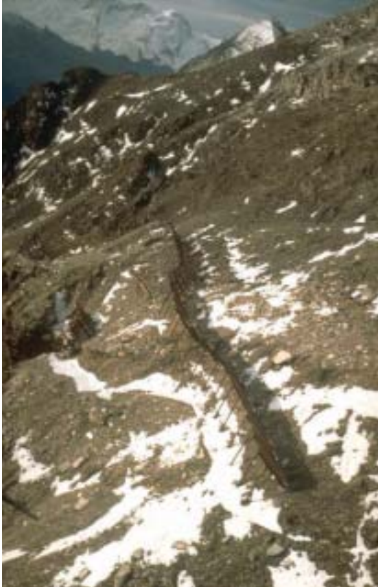
Abb. 8: Lawinerverbauungen bei Wisse Schijen oberhalb von Randa im Mättertal (CH). Die Deformation der Strukturen durch die Kriechbewegungen des Hanges sind deutlich sichtbar: ca. 1,5 m in 5 Jahren. Die Verbauungen wurden unterdessen entfernt und an anderer Stelle neu aufgestellt. Foto: Stefan Margreth (SLF).
